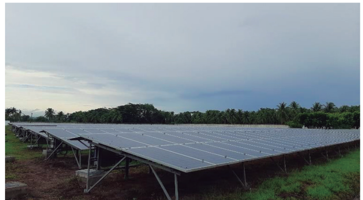
Fig. 1. Paneles solares de la planta Renovables El Salvador Uno
