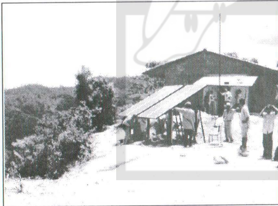
Figura 15 Generador fotovoltaico de 960 W-p instalado en el SFC-I
